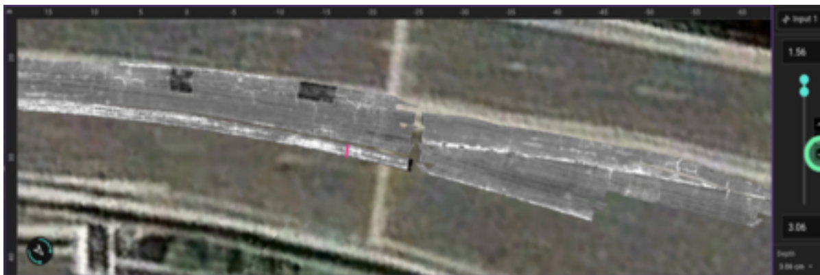
沥青层的主要表面缺陷（裂缝）
